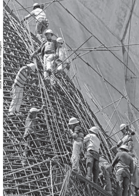
Construção da usina hidrelétrica Itaipu, em Foz do Iguaçu (PR). Foto de 1981.
